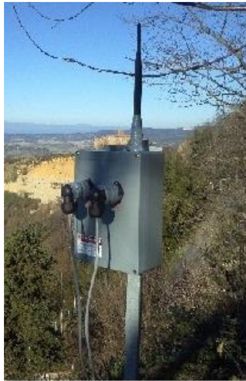
Guardian™ collegato a due sensori sul fronte della frana.
